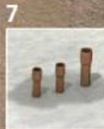
Lekkage bij doorvoeren van blifv. leidingen
